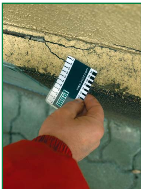
použití orientační měrky pro stanovení rozevření trhlin
